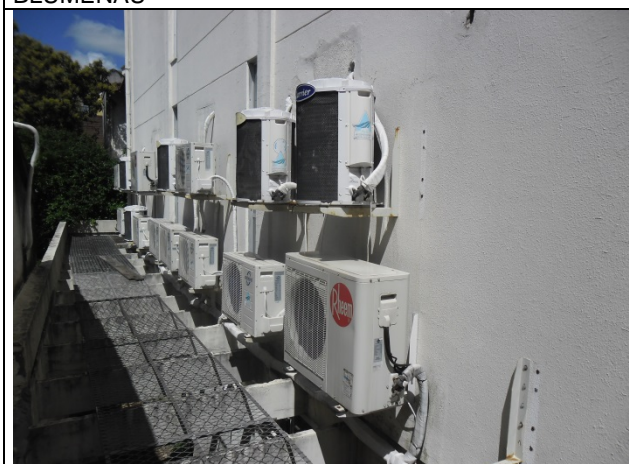
Foto16: Contrato em execução de empresa de manutenção de ar condicionado – SEDE ADM FLORIANOPOLIS
